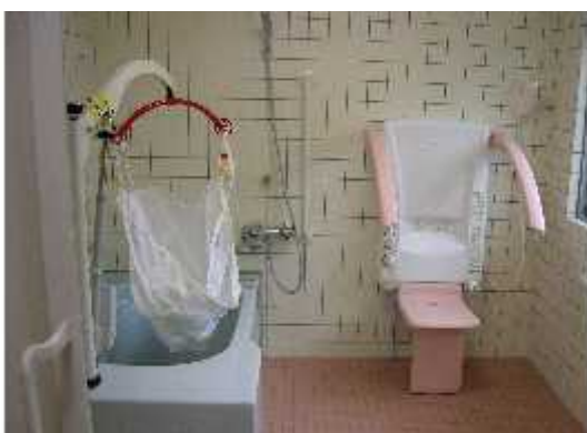
腰掛式全身シャワーとリフトつき浴室
